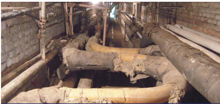
Czerwiec 2011 - kanał ciepłowniczy pod krytą bieżnią przed modernizacją
