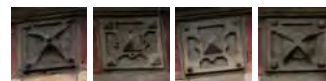
Płytki pochodzące ze ściany południowo wschodniej, wykonane z innego materiału, o mniejszej dbałości i niedokładnym odwzorowaniu
