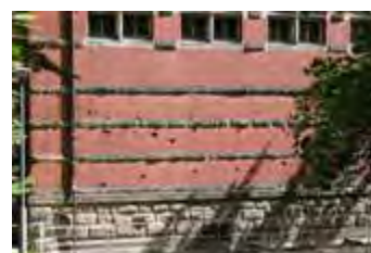
Ściana zawierająca ślady po kulach (południowo wschodnia część gmachu)
