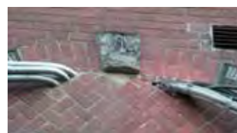
Rury instalacji klimatyzacyjnej oraz ujście kanału wentylacyjnego, szpecące detale ściany zachodnio północnej
