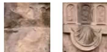
Zniszczone miejsce w którym powinien być symbol
