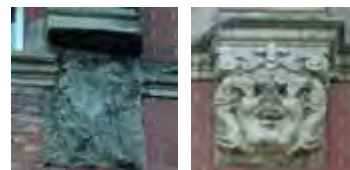
Zniszczony detal i propozycja rzeźby, która powinna być w tym miejscu
