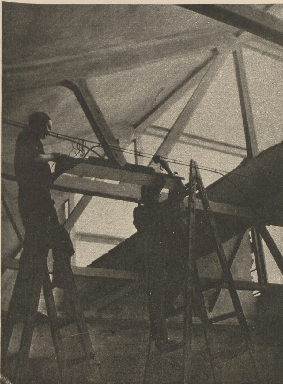
WYSOKO, POD STROPEM BŁYSZCZEĆ BĘDĄ ŚWIATŁA JARZENIOWE....
