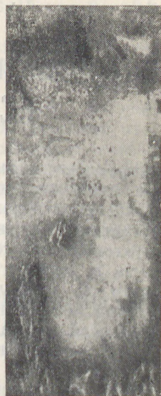
Рис. 3. Вид поверхности образца из стали СХ1 после 12 месяцев испытания на коррозию в морской воде при частичном погружении
