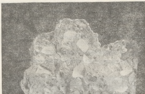
Рис. 1. Излом бетона оболочки из подводной зоны (на поверхности бетона видна тонкая защитная кромка карбоната кальция)
