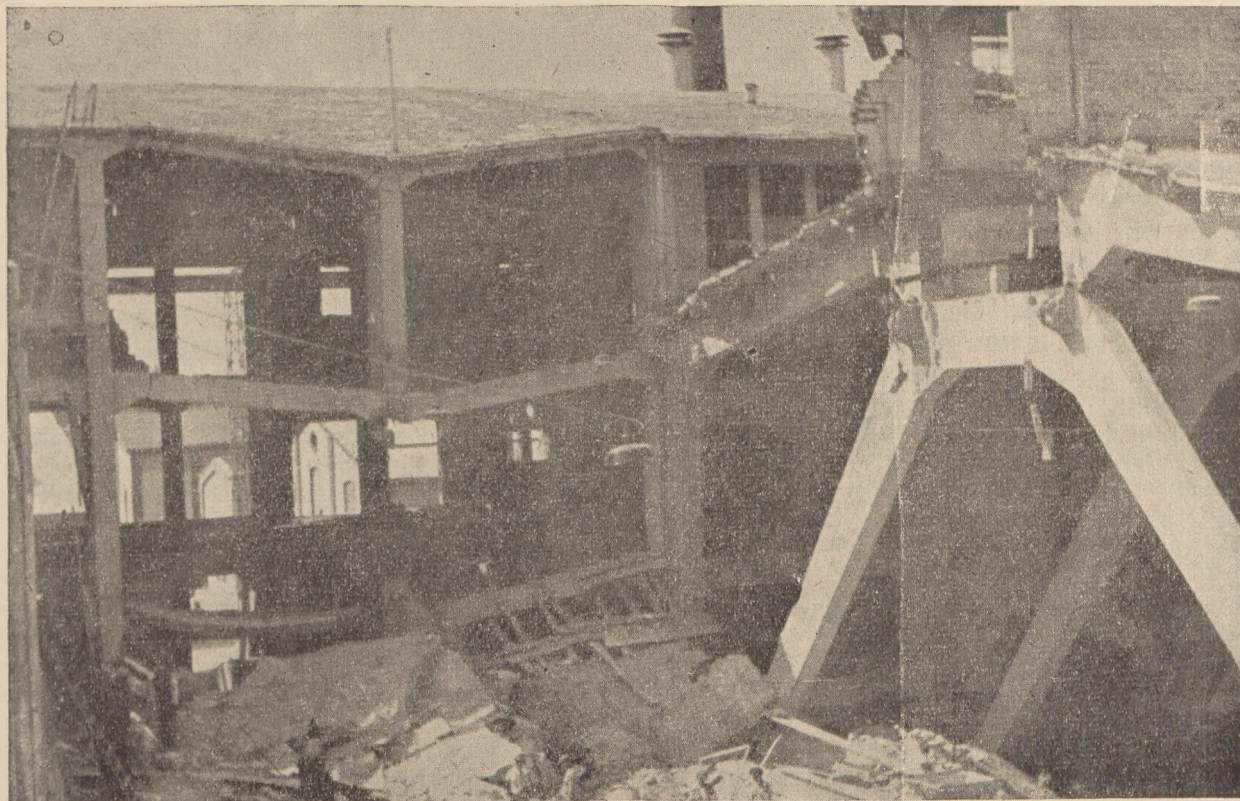
Zapadnięty stropodach żelbetowy cementowni „Odra“ przed odbudową.
