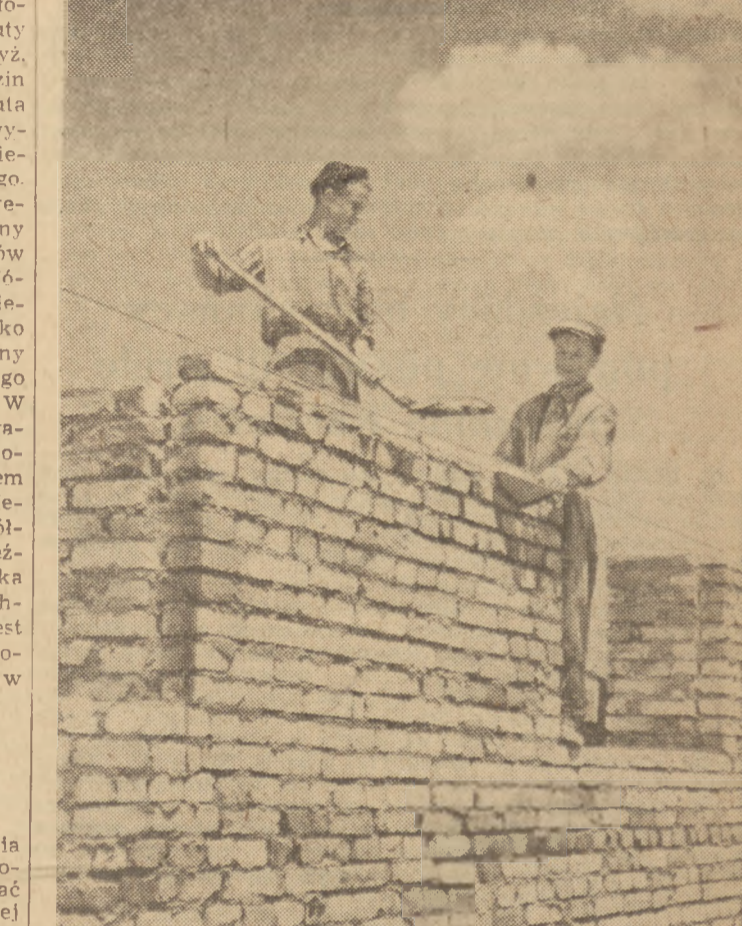
Młodzież pracująca na budowie osiedla mieszkaniowego na Grochowie w Warszawie podejmuje zobowiązania na cześć Złotu Młodych Pracobników. Na zdjęciu: członkowie młodzieżowej dwójki murarskiej — Wincenty Skorpinski i Eugeniusz Grabowski, którzy dla uczczenia Złotu postanowili wykonywać do 22 lipca po 6,5 metra szczytnego muru dziennie, zwiększając przy tym oszczędność materiałów budowlanych.
