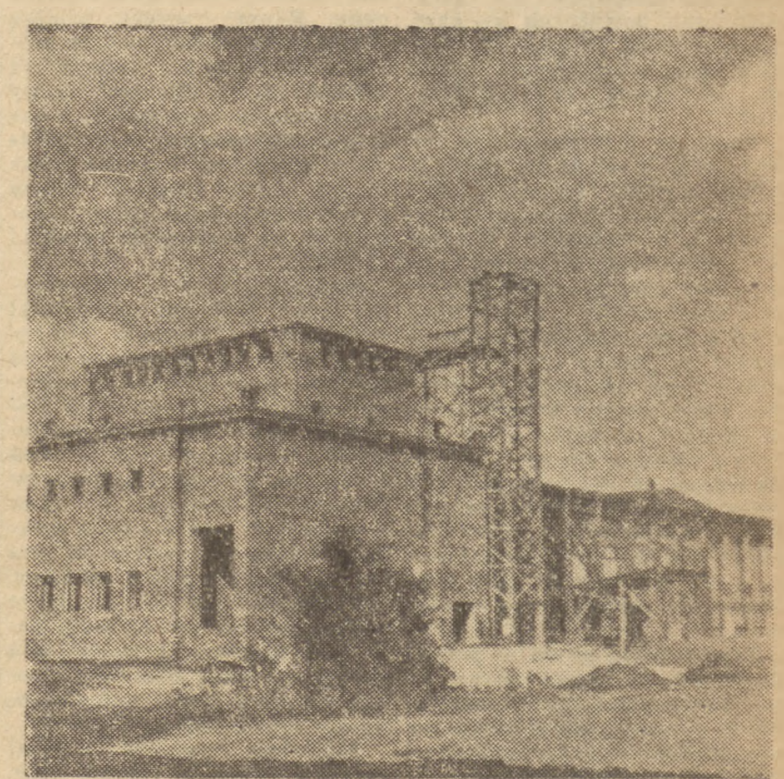
Przy Krasniańskiej Fabryce Metalowej powstaje w szybkim tempie osiedle mieszkaniowe. Na zdjęciu: fragment budowanego Domu Kultury. Foto CAF — Wierucki
