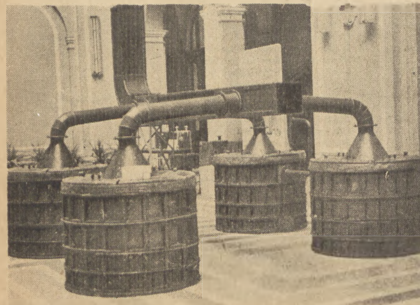
A oto kwasoodporna instalacja wykonana całkowicie z winiduru. Instalację tę oglądaliśmy niedawno na wrocławskiej wystawie postępu technicznego. (Foto J. Kalisz)
