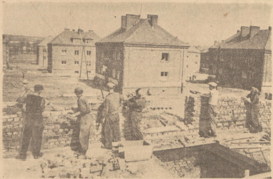
Zalogi budowlane miasta Nowa Huta podjęły szereg cennych zobowiązań produkcyjnych. Realizacja tych zobowiązań sprawiła, że szybciej powstała nowe mieszkania dla budowniczych Nowej Huty. Na zdjęciu: brygada młodzieżowa Bogdana Cybernika, wykonująca przeciętnie 160 procent normy. Foto CAF - Tyminski
