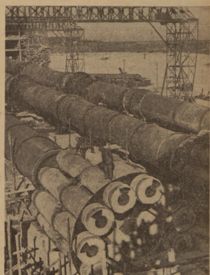
Już w maju przyszłego roku nastąpi rozruch wielkiej, nowoczesnej cementowni Rejowiec II. Na zdjęciu: fragment pieców obrotowych Pierwszej z nich dzięki zobowiązaniu załogi podjętej dla uczczenia 36 rocznicy Rewolucji Październikowej przygotowano do wymurówki na 15 dni przed terminem.
