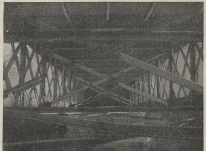
Abb. 8. Sprengwirkung an den Querverbänden.
