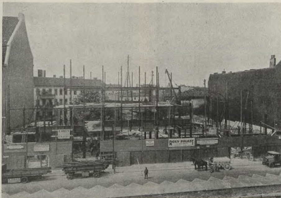
Abb. 10. Blick auf die Straßenfront mit den Abfangträgern im Erdgeschoß; rechts hinten die Kinodachbinder.
