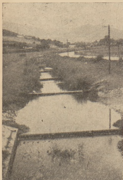
Rys. 1. Potok Świdnik Tęgoborski 300 m od ujścia do Dunajca. Korekcja progowa w 30% zniszczona
