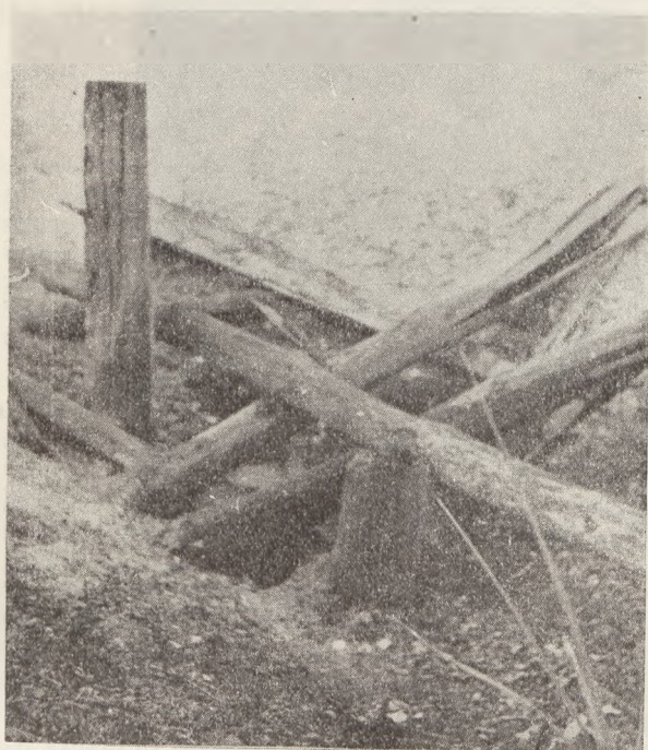
Rys. 3. Zawalona obudowa na dnie wyschniętego zbiornika
