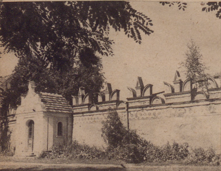
Fragment ozdobionej renesansową attyką muru obwodowego pałacu w Trzebinie. Z prawej strony widoczne wyraźnie uszkodzenie dekoracji sgraffitowej.
