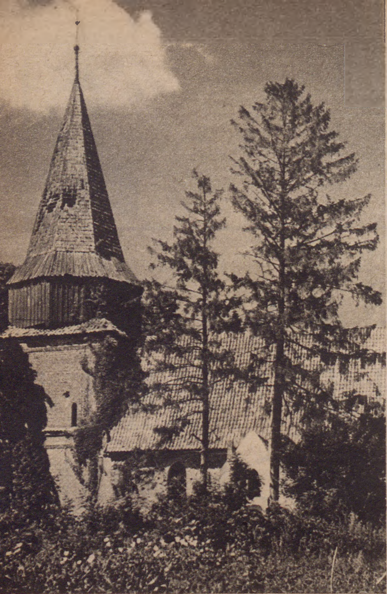
Obok: gotycka kaplica w Orłowie koło Nowego Stawu. Dziura w dachu charakterystyczna dla stanu zachowania budynku. Czy strop zdążył już przegnić? Fot. T. Chrzanowski. Poniżej: kościół w Lubieszewie, zbudowany około roku 1400. Wieża natomiast pochodzi z roku 1573. Widoczny na zdjęciu stan konserwacji zabytku wywołuje podobne pytanie jak przy zdjęciu poprzednim. Fot. Tadeusz Chrzanowski. U dołu: wieś żuławska Kończewice. Na tylnym planie widoczna drewniana wieża zabytkowego kościoła. Fot. Jerzy Tukałło
