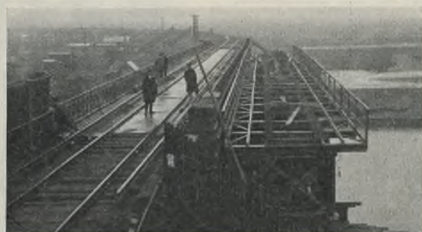
Abb. 23. Die Brücken vor der Auswechslung.
