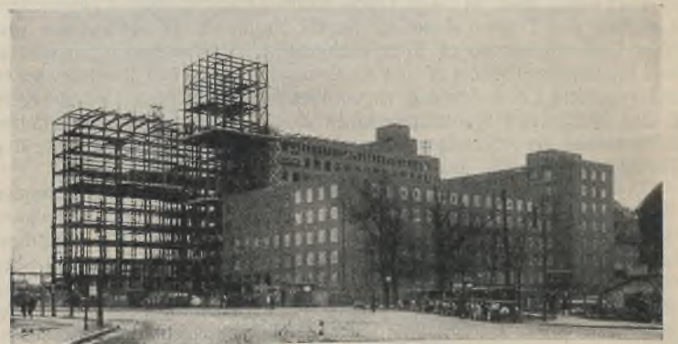
Abb. 21. Dieser Bauzustand kennzeichnet die der Stahlskelettbauweise eigentümlichen, zweckmäßigen Möglichkeiten in der zeitlichen Reihenfolge der Ausführungen einzelner Bauabschnitte.
