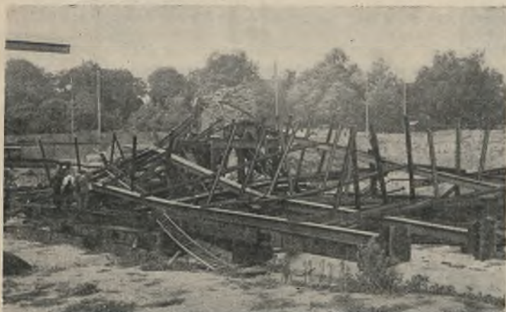
Abb. 13. Die umgekippten Stützen mit Fußplatten.
