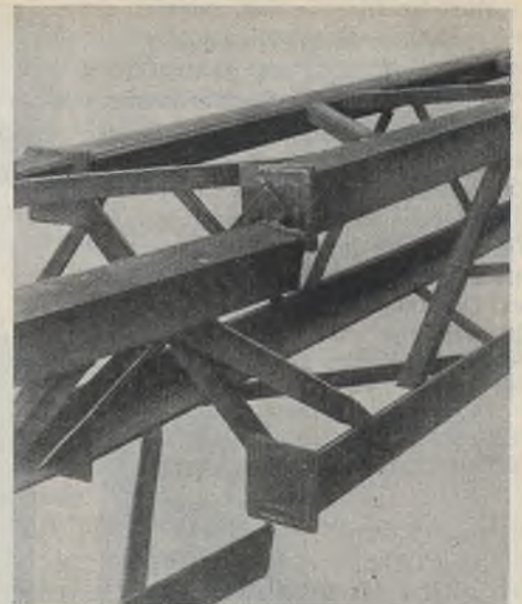
Abb. 22. Vorzeitig zerstörte, geschweißte Stoßstelle bei Mast VIII.
