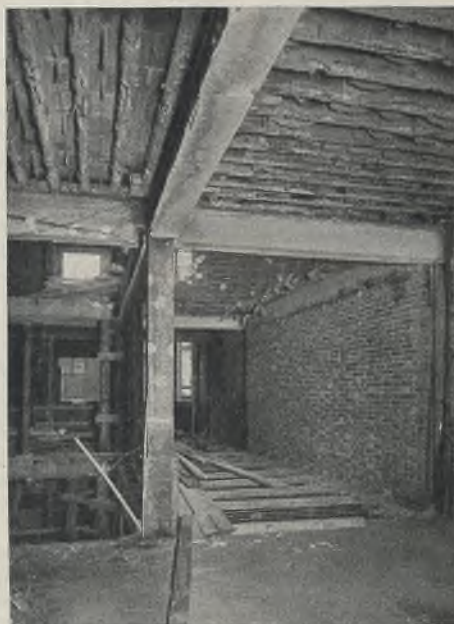
Abb. 10. Brandschäden der Decken.
