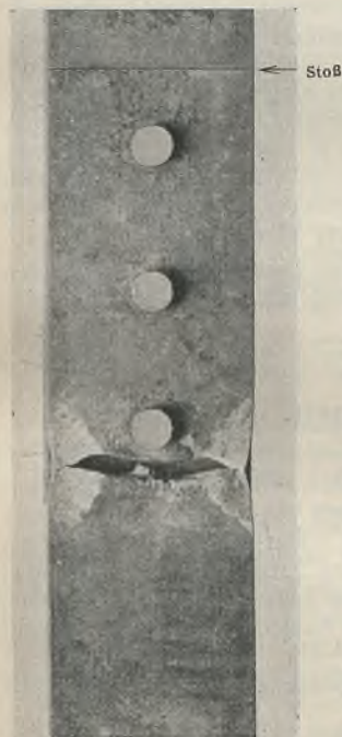
Abb. 1. Dauerbruch vor dem Nietloch (eine Lasche abgenommen).
