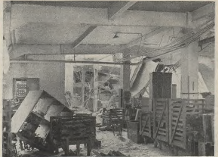
Abb. 6. Blick vom Binderfeld 6—5 nach der Zerstörungsstelle.
