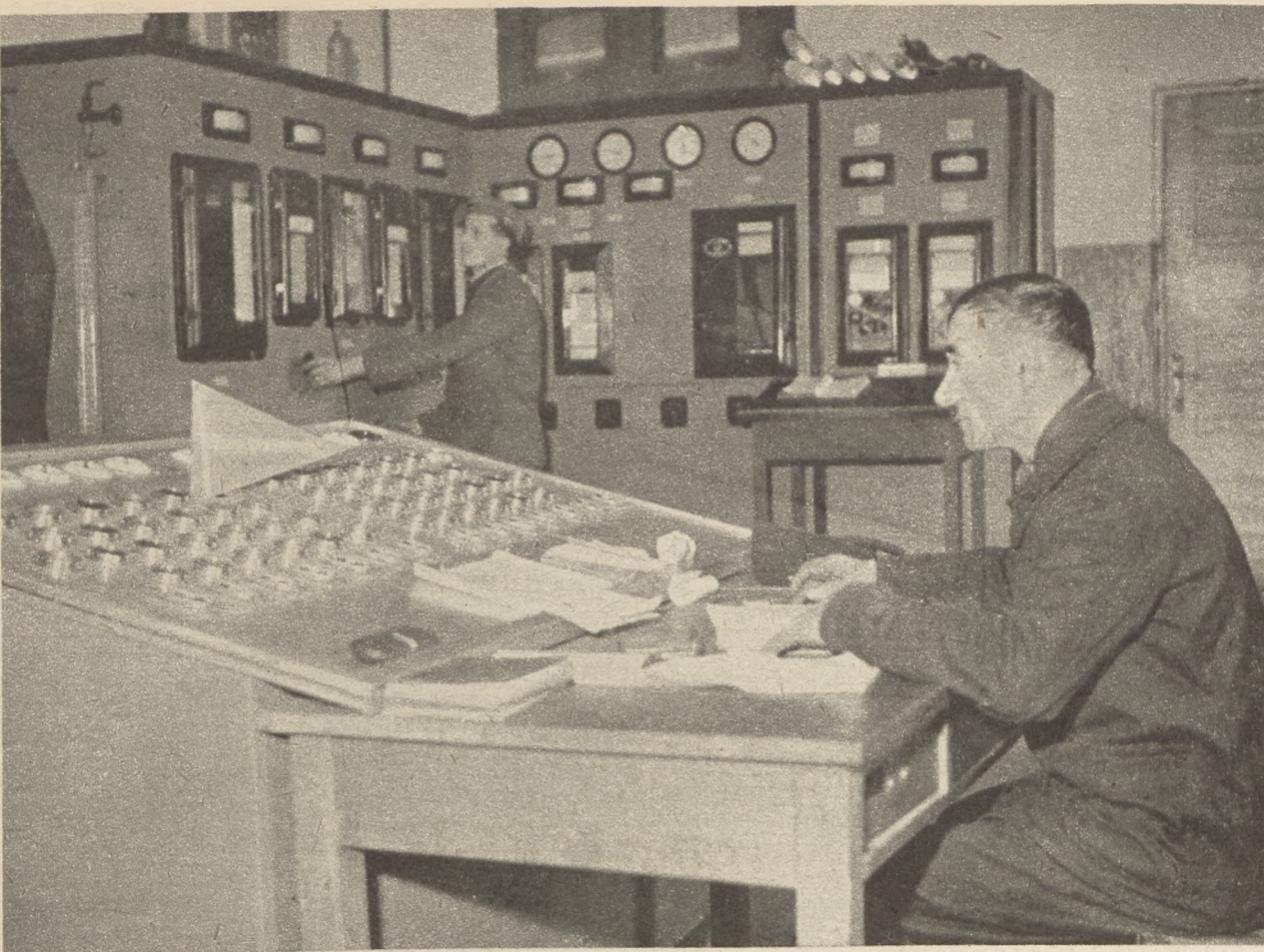
Zakłady Wielkiej Syntezy Chemicznej w Dworach pod Oświęcimiem należą do rzędu najnowocześniejszych. Dzięki scentralizowaniu urządzeń cały skomplikowany proces produkcji może kontrolować jeden tylko człowiek
