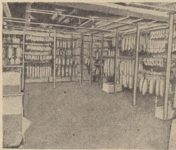
Rys. 1. Chłodzony magazyn wędlin z wmontowanymi promiennikami
