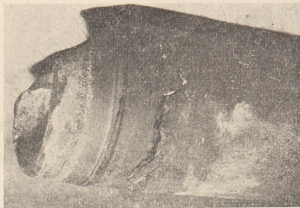
Rys. 1. Pęknięcie i wyrwanie z walczaka rury ekranowej wskutek nieodpowiedniego zawalcowania, co spowodowało uszkodzenie rur sąsiednich i obmurza. Kocioł wysokoprężny 64 atn 100 t/h. Awaria z 12. II. 1952
