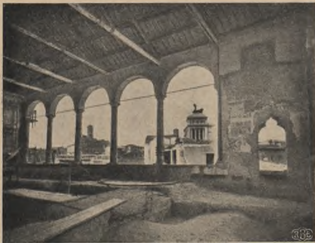
18. Widok loggji „kawalerów” od strony wewnętrznej, po wyburzeniu przerońek z w. XVII.
