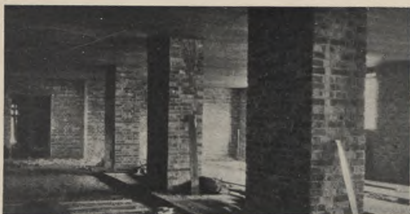
2. Podciągi, łączące poszczególne filary w sali jadalnej, ukryte są w wysokości stropu skrzynkowego w budynku Państwowego Gimn. im. J. Słowackiego w Warszawie. Projektował arch. T. Nowakowski (Warszawa).
