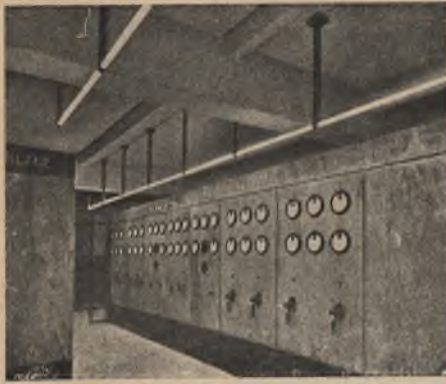
19. Sala desek rozdzielczych w elektrowni w Bielefeld.
