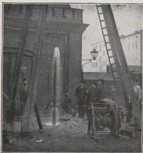
Artesischer Springbrunnen der A.-G. „Archimedes“ in Breslau.
