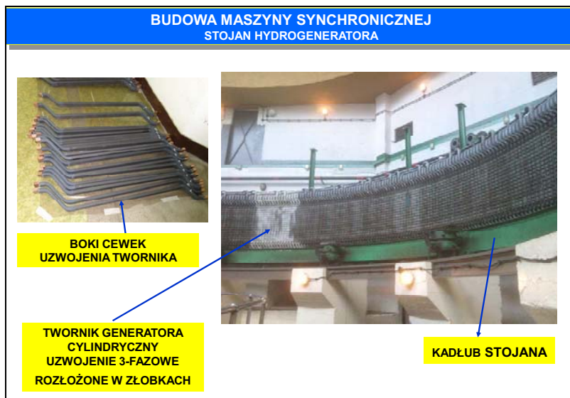
Rys. 6.8. Stojan hydrogeneratora – Elektrownia Wodna we Włocławku (fot. Mikołaj Kiełczyński)
