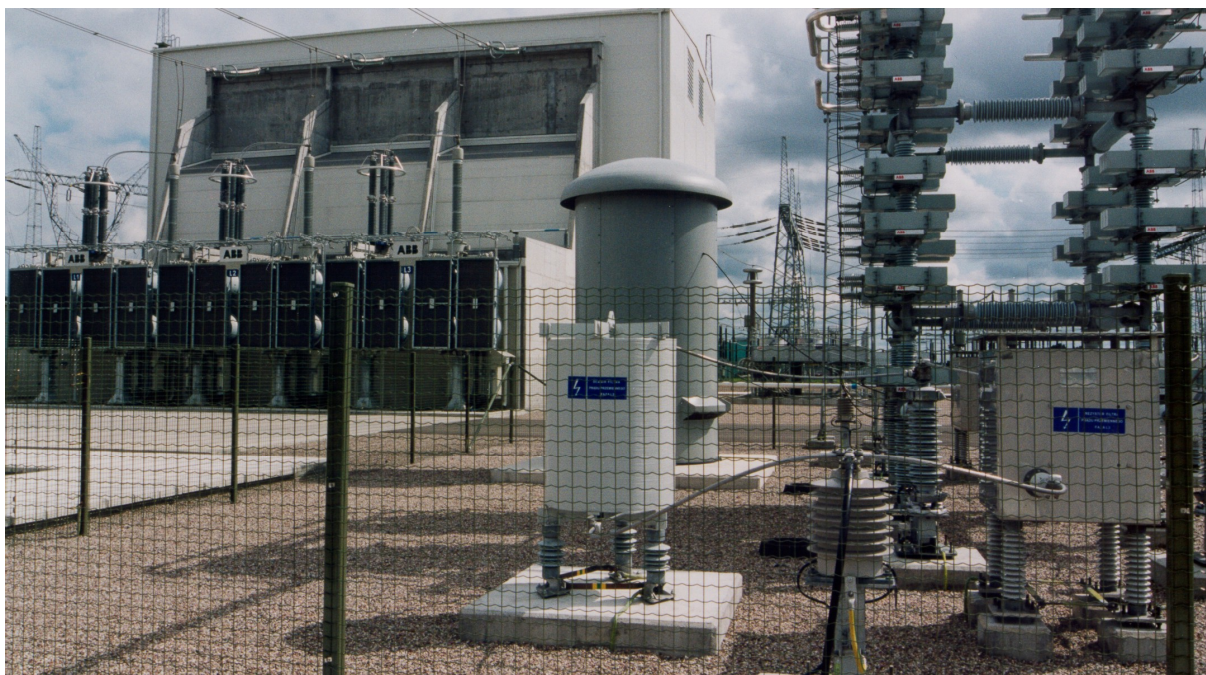
Rys.3.11. Widok ogólny na transformatory przekształtnikowe wg [źródła własne]
