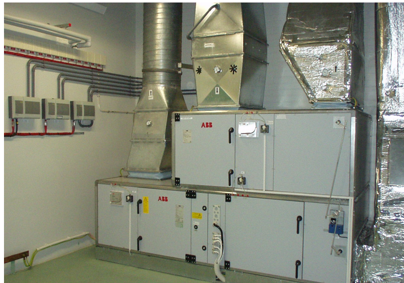
Rys.3.10. Agregat wentylacyjny hali przekształtników wg [źródła własne]
