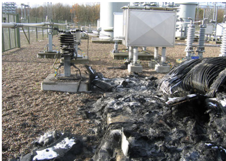
Rys.4.3. Zgliszcza spalonego filtra 11-tej harmonicznej po polskiej stronie w 2005 roku wg [źródła własne]
