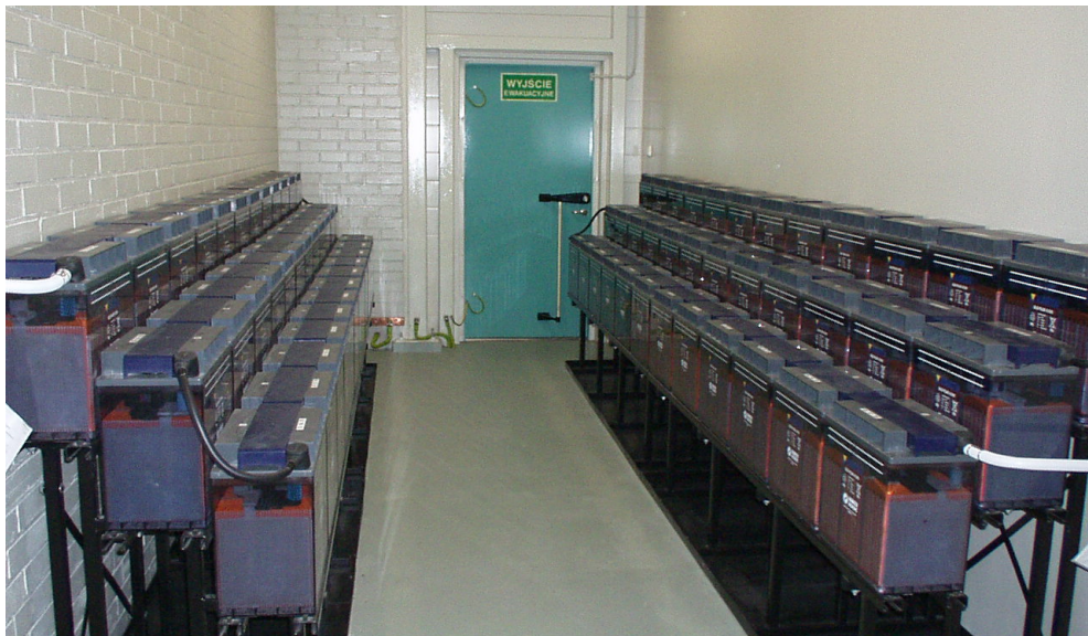
Rys.3.15. Pomieszczenie baterii akumulatorów wg [źródła własne]
