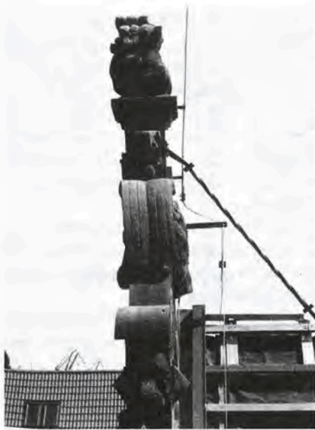
Fot. 3a. Wychylone kamienne zwieńczenie szczytu (szczyt zakotwiono w 2002 r.)
