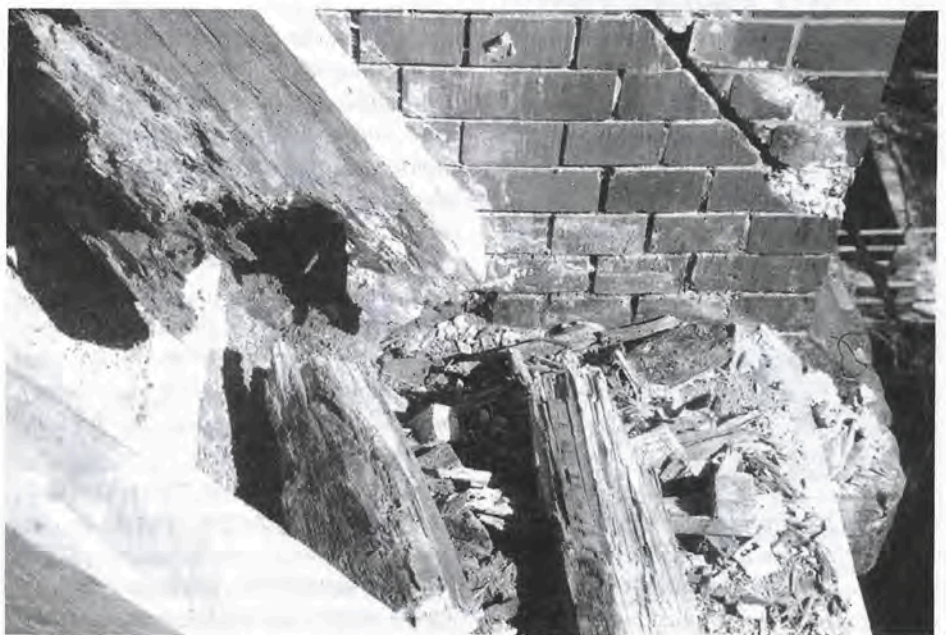
Fot. 2. Spróchniałe murlaty i końce krokwi (stan 22.04.2002 r.)
