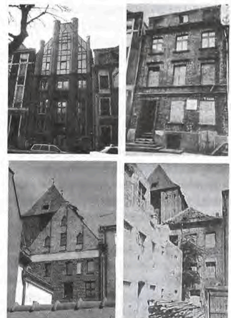
Fot. 1. Z lewej strony widok elewacji frontowej po generalnym remoncie i regotyżacji kamienicy w latach 1992-1994; z prawej – stan przed remontem
