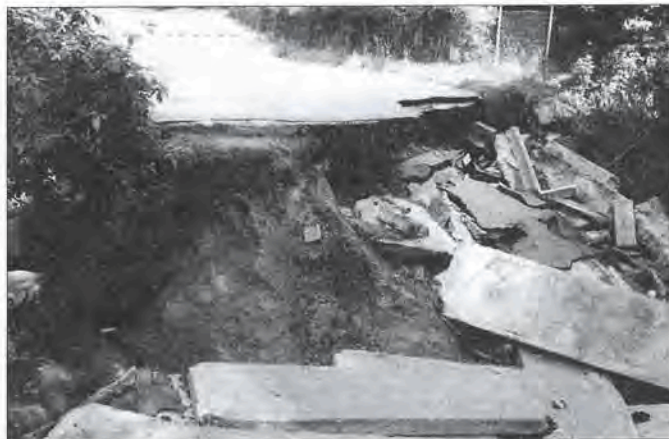
Zerwany most na Strzyży w rejonie ul. Potokowej, lipiec 2001 r.
