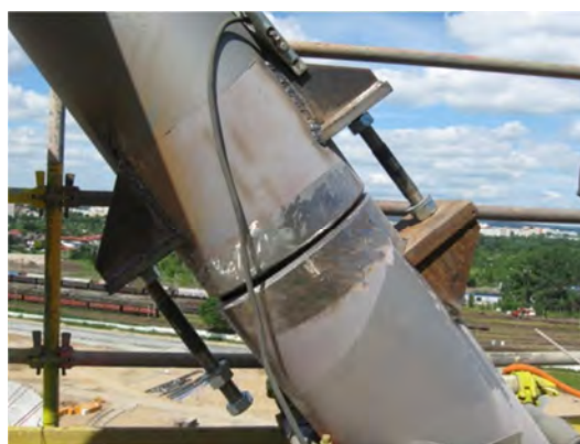
Rys. 91 Przerwa w miejscu styku rur
