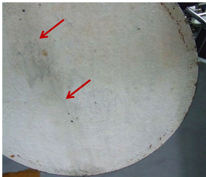
Rys. 103 Miejsce zarysowanie betonu
