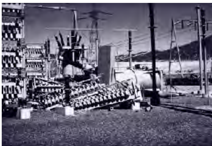
Rys. 1.2. Stacja elektroenergetyczna uszkodzona podczas trzęsienia ziemi San Fernando, 9.02.1971 ( http://peer.berkeley.edu ).
