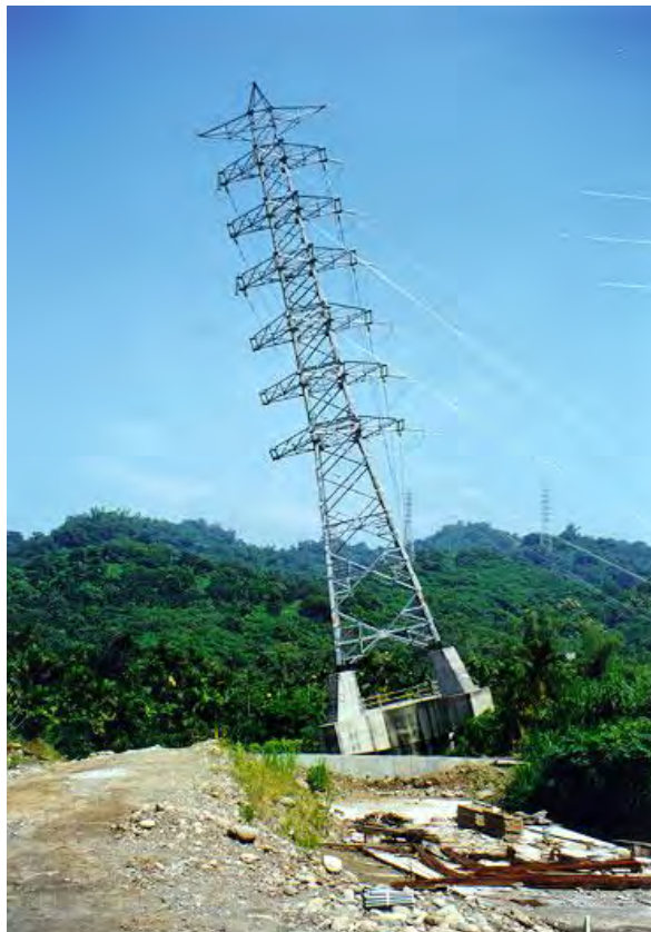
Rys. 1.1. Wieża transmisyjna uszkodzona podczas trzęsienia ziemi Chi-Chi na Tajwanie, 21.09.1999 ( https://www.eeri.org ).
