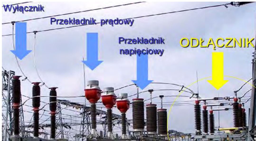
Fot. 2.1. Fragment stacji elektroenergetycznej wysokiego napięcia ( http://www.hapam.pl ).
