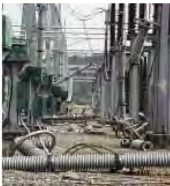
Rys. 1.4. Odłącznik wysokiego napięcia uszkodzony podczas trzęsienia ziemi Northridge, 17.01.1994 ( http://earthquake.tier.org.tw ).
