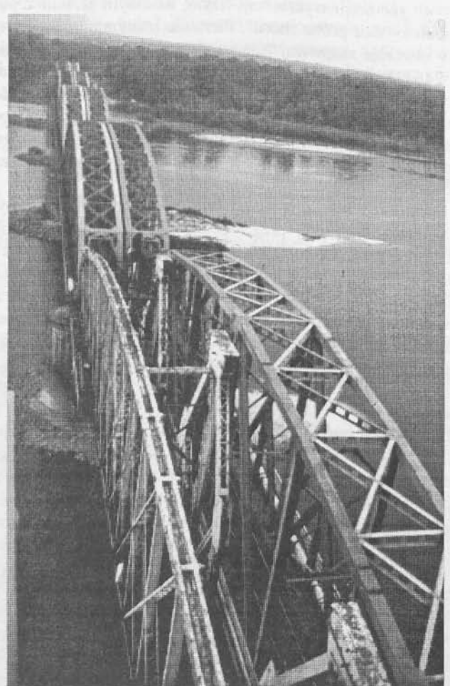
Most w Toruniu - na pierwszym planie rozbiórka środkowego i lewego dźwigara starej konstrukcji przęsła
