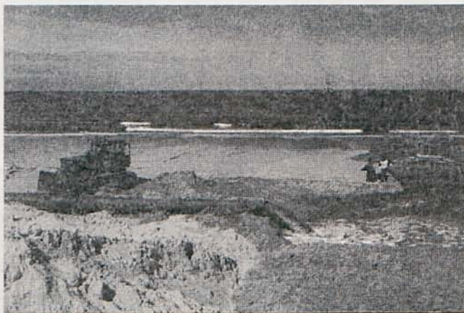
Rys. 5. Półwysep Hel. Sztuczne zasilanie plaż rumowiskiem piaszczystym czerpanym z dna morskiego i dostarczonym podwodnym rurociągiem na plażę. (Fot. T. Chmielowiec)
