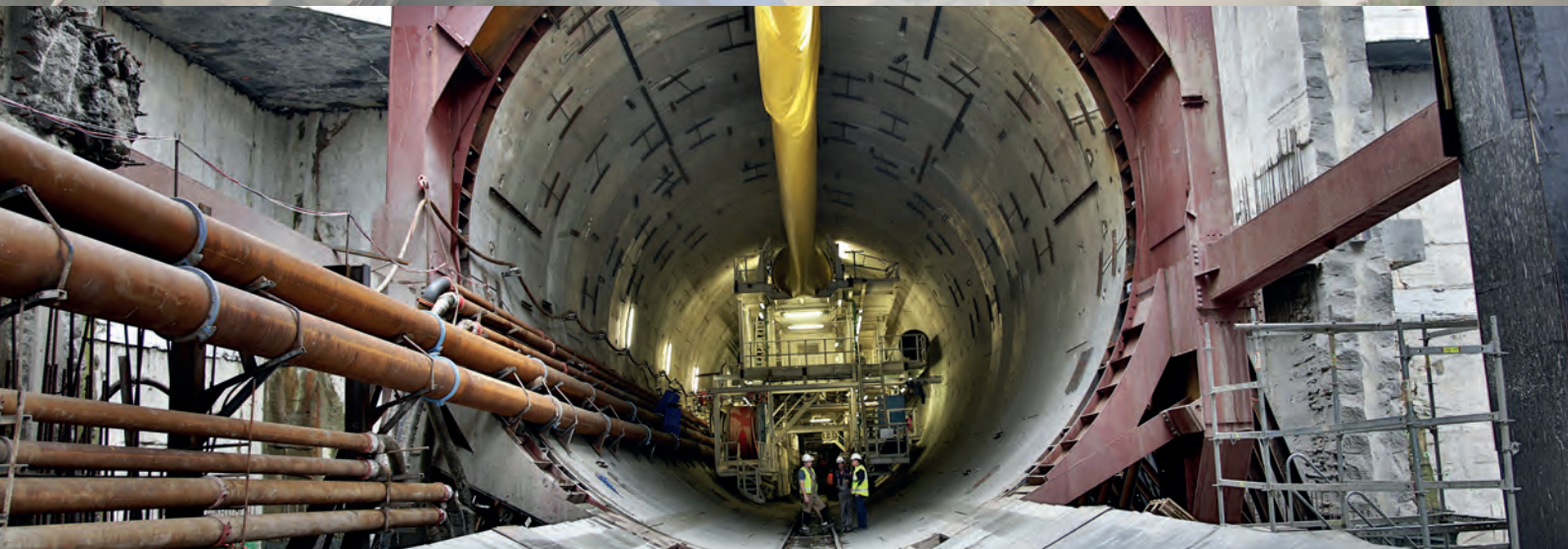
Fot. 2. Tył maszyny TBM w wydrążonej rurze tunelu Fot. z archiwum GIK
