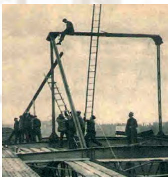
Fot. 8. Montaż konstrukcji wsporczych na moście w Grudziądzu Fot. ze zbiorów Elektrowni Wodnych w Samociążku
