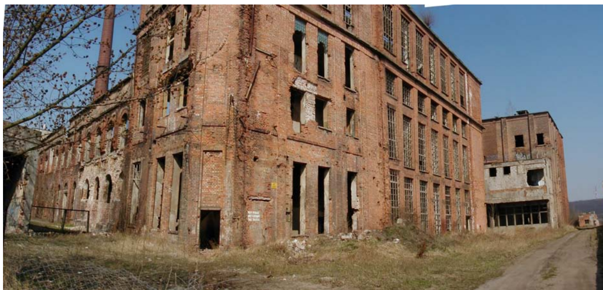
Fot. 5.126 5.127. Cenne dziedzictwo architektury przemysłowej w stanie agonii. Struktura przestrzenna w tak złym stanie, że niemożliwe jest już jej uratowanie dla potrzeb współczesnej tkanki miasta.
