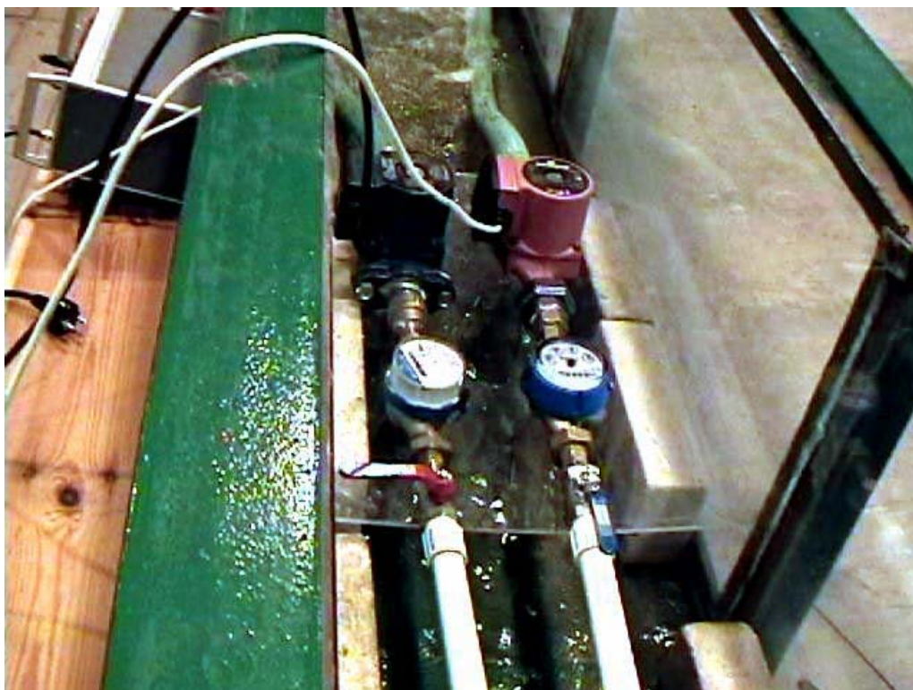
Fot. 6.5. Układ pompujący wodę ze szczeliny “recyrkulacyjnej”
