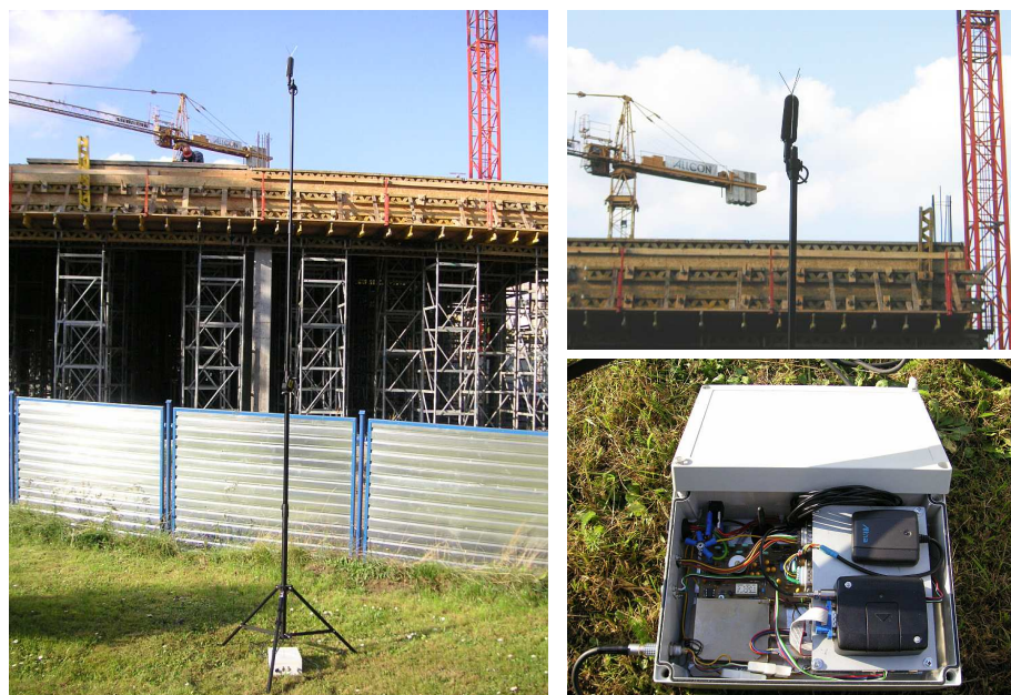
Rys. 5.3. Stacja pomiarowa wraz z mikrofonem pomiarowym
