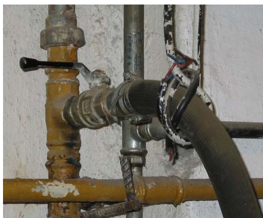
Fot. 3.3. Zawór kulowy na zasileniu zbiornika hydroforowego.
