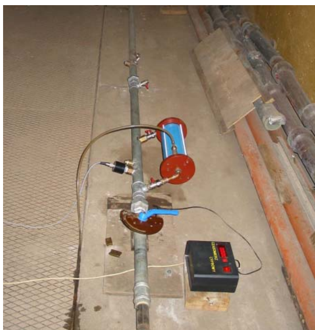
Fot. 3.1. Rurociąg stalowy wraz z boczniakiem i przyrządami pomiarowymi.
