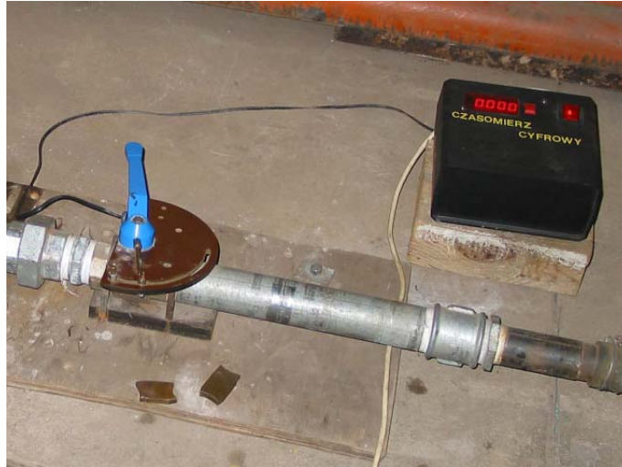
Fot.3.4. Zawór kulowy na końcu przewodu i czasomierz cyfrowy.
