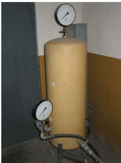
Fot. 3.2. Zbiornik hydroforowy.
