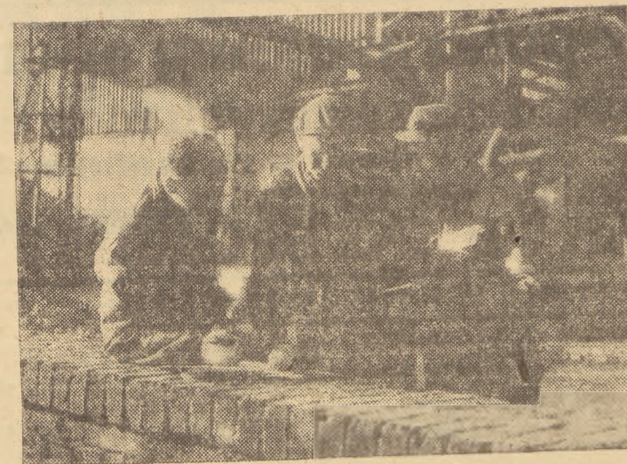
Pracownicy huty „Kosciuszko” tow. tow. Petryk, Piotrowski i Szebesta stale wprowadzają nowe ulepszenia. Ostatnio przebudowanie przez nich szlaku do paleniska dało 445.000 zł oszczędności rocznie. Przez zwiększenie komory spalania usprawnili działanie kotłowni — co w efekcie dało 1.200.000 złotych oszczędności rocznie. Nowym pomysłem jest projekt przebudowy palenisk kotłowni (Foto — AR).
