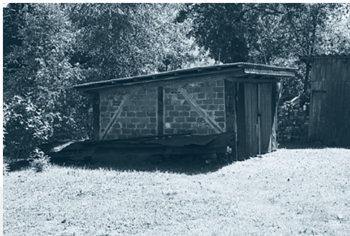
Przykład zubożenia architektury regionalnej– budynek gospodarczy wykonany w konstrukcji „pruskiego muru”, czyli szachulcowej częściej na badanym obszarze – Tropy Elbląskie, 2010
