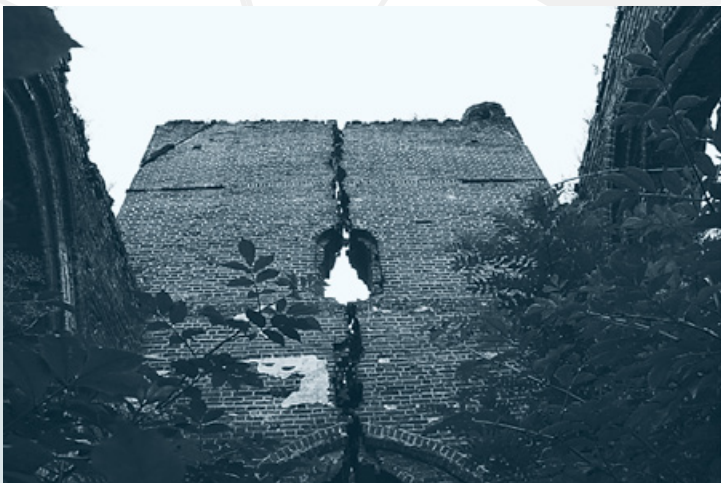
Fiszewo, ruiny gotyckiego kościoła, widoczne pęknięcie wieży w jej osi symetrii, stan obecny nawy głównej, 2010
