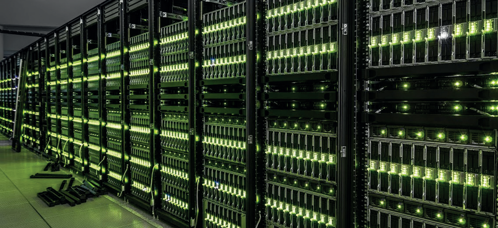
Fot. 2. Montaż klastra obliczeniowego
