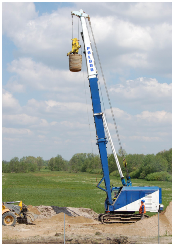
Rysunek 3.2: Urządzenie wykorzystywane do formowania kolumn w technologii DR firmy Polbud-Pomorze, fot. własna.
