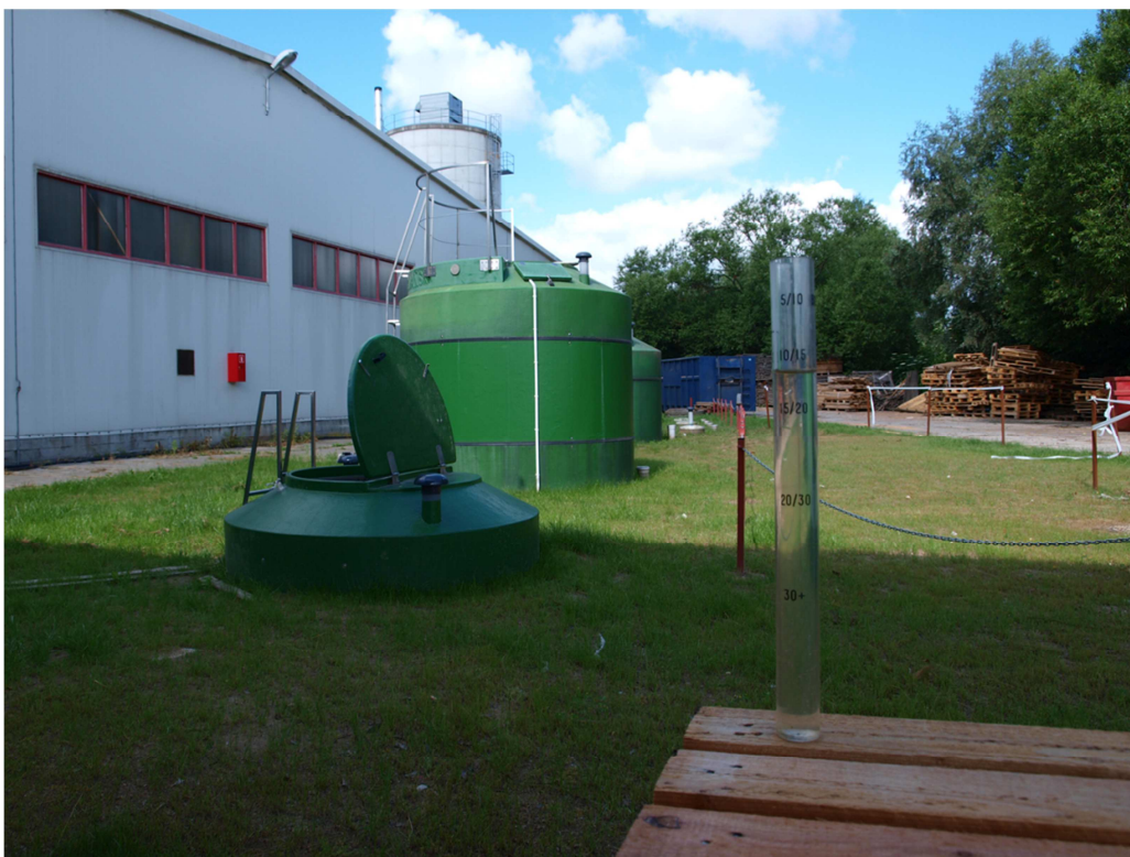
Rys. 10.4. Widok na oczyszczalnię w Gronowie Górnym, na pierwszym planie naczynie ze ściekami oczyszczonymi, w dali: naziemna część reaktora MBBR i złoża biologiczne
