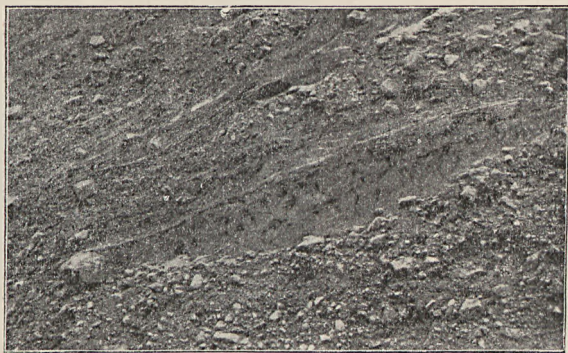
Skärning i morän med gynniga partier af finskiktad sand. C:a 12—13 m 2 . Vid km 51 Ofotenbanan. 13/7 99.
