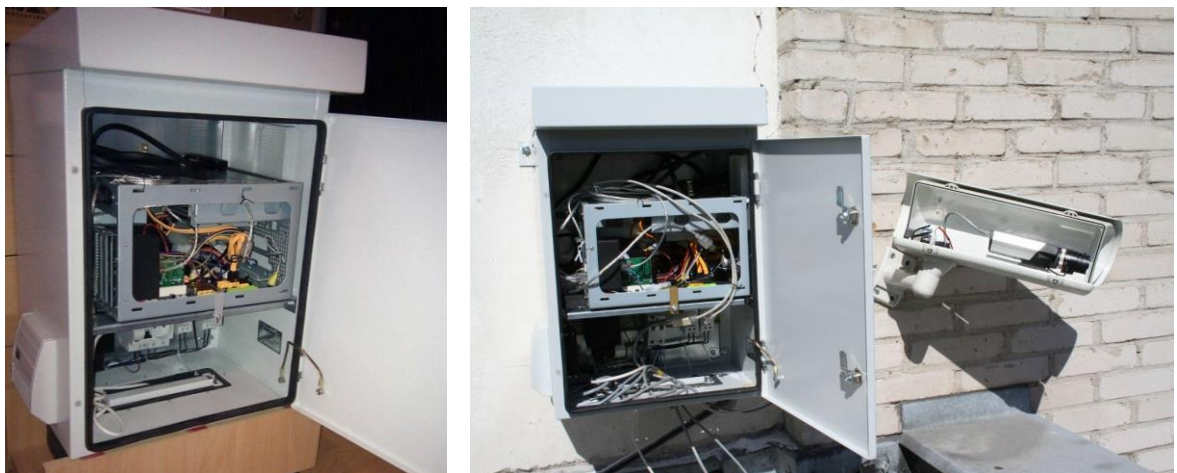
Rys. 10.6 Stacja Monitorująca zamontowana w obudowie zewnętrznej (z lewej) oraz przykładowa instalacja stacji wraz z kamerą na fasadzie budynku (z prawej)
