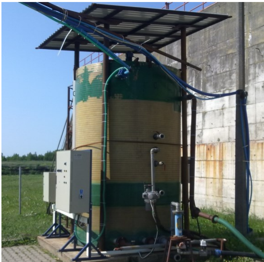
Rys. 3.3. Pilotowy reaktor SBR zlokalizowany w oczyszczalni ścieków Wschód w Gdańsku: (a) schemat układu, (b) widok rzeczywisty
