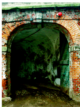
Ryc. 5.6. Skutki skumulowane i synergiczne powodują erozję murów Twierdzy Wisłoujście i występowanie grzyba oraz pleśni (fot. autora)
