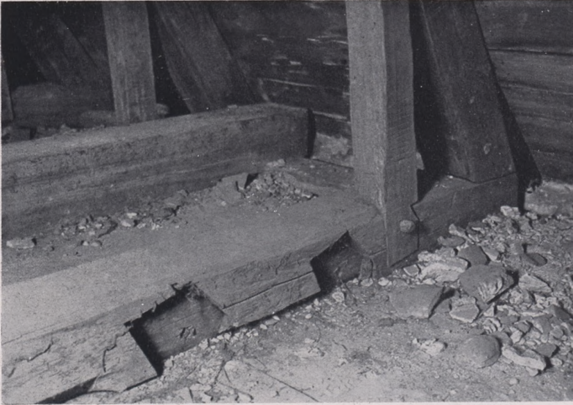
Schönsee. Kath. Kirche. Ein Bal- ken aus der Dachkon- struktion mit sicht- baren Überresten des alten Fachwerkbaues (Kopfbänder).
