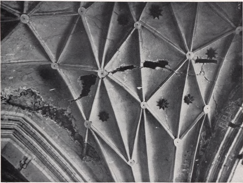
St.=Marien=Kirche, Gewölbekappen im Hallenchor mit Rissen.
