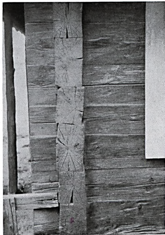
Abb. 74: Vorstöße von einem Wohnhaus aus Zillertal bei Hirschberg in Schlesien mit verdrehten Balkenköpfen. Dieses Bauwerk wurde vor etwa 100 Jahren zusammen mit einer aus mehreren Höfen bestehenden Siedlung errichtet. Um den aus dem Zillertal in Tirol kommenden Verbannten rasch eine Heimstätte schaffen zu können, hat man das Bauholz vor dem Aufrichten nicht so stark austrocknen lassen können, wie es sonst der Brauch war. Deshalb verursachten die aus dem Kern herausgeschnittenen Blockbalken durch ihr Schwinden an den Vorstößen Verdrehungen. Auch die am Hirnholz auftretenden Risse und Klüfte entspringen der gleichen Gefahrenquelle.
