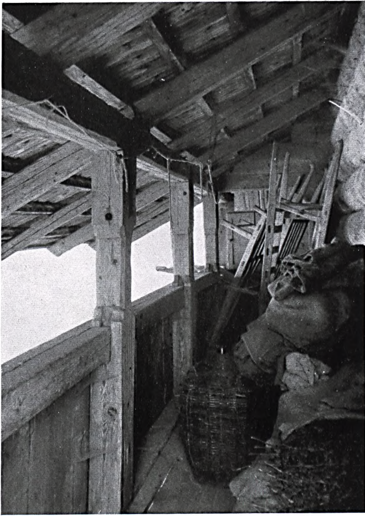
Abb. 324: Laubensäulen von einem Speicher aus Waldhaus, Kanton Bern. Um die Schlitz für die Gezapfen der Brustriegel herausstechen und das Einfügen derselben ermöglichen zu können, mußten zum mindesten in der Stärke des Riegels über diesem Gefüge Ausschnitte gemacht werden. Man führte sie weiter hoch und gestaltete in Form einer leicht geschwungenen Welle einen Übergang zur Grundform. (Vgl. Abb. 323/3.)
