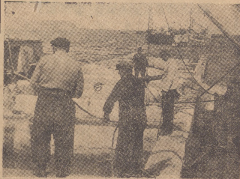
W porcie gdyńskim w re pracą nie tylko przy nabrzeżach. Od dwóch lat remontuje się również zniszczone przez Niemców falochrony w awanporcie. (Fot. Uklejewski)
