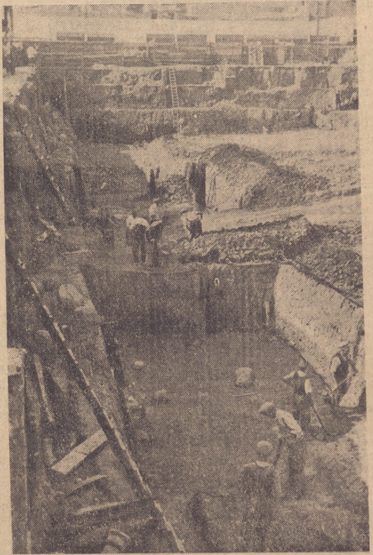
Na rogu ul. Brackiej i Alei Sikorskiego, za wysokim parkanem kopie się fundamenty pod sześciopiętrową siedzibę Powszechnego Domu Towarowego. Ziemia jest prawie skalista i nie można tu stosować mechanicznych kopaczek. Zwaly stwardniałego gruntu rozbija się ręcznymi kilofami. Przyszły budynek PDT będzie najnowocześniejszym typem domu towarowego. Nowością będą tu nie tylko obszerne pomieszczenia sklepów i hal, ale również ruchome schody przewożące klientów od parteru aż na szczyt budynku. (Fot. API)
